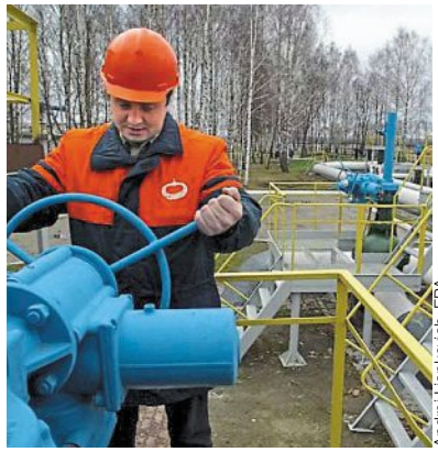
Une station de pompage sur l'oléoduc de l'Amitié en Biélorussie.
